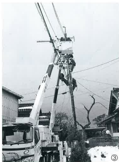
③町内各地で停電が発生し、懸命の復旧作業が行われた。(平田地区)
