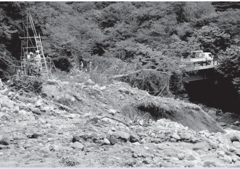
台風12号で崩壊した県道「川床橋」付近
