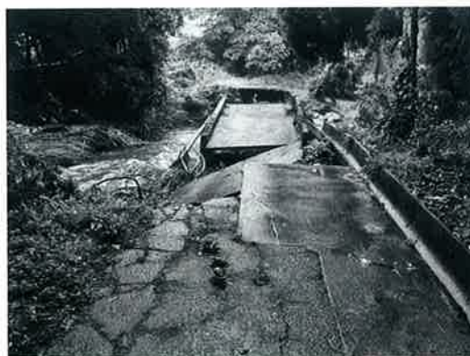
▲台風12号災害により崩落した新佐摩橋
