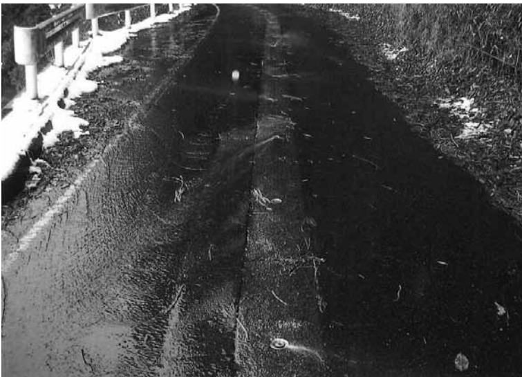
水が吹き出る消雪設備(道路中央)
