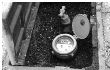
水道メーター
