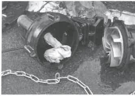
▲下着が詰まり、ポンプが稼働停止したところ
