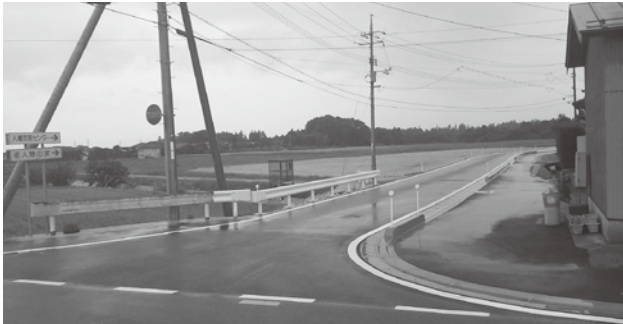
工事完了の遅れた町道
