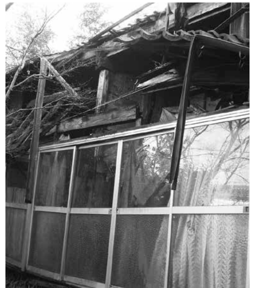
急がれる空き家対策
