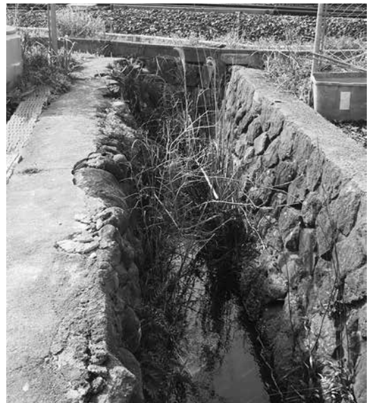
大雨のたびに床下浸水が起こる
