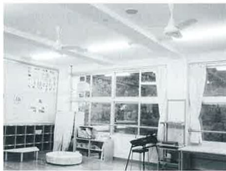
▶省エネのため、普通教室に天井扇を設置
