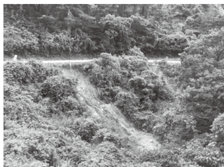
▲土砂崩れ発生時
