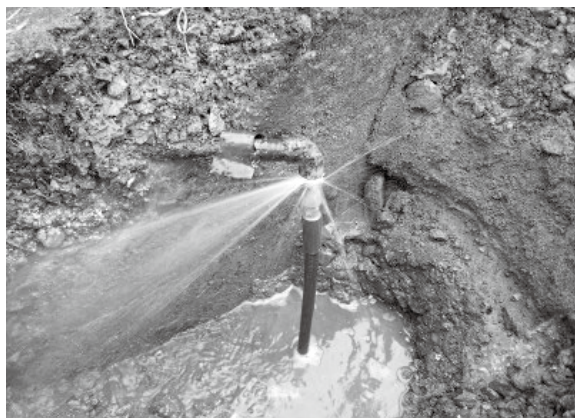
▲老朽化した水道管
