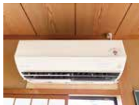
設置されたエアコン
