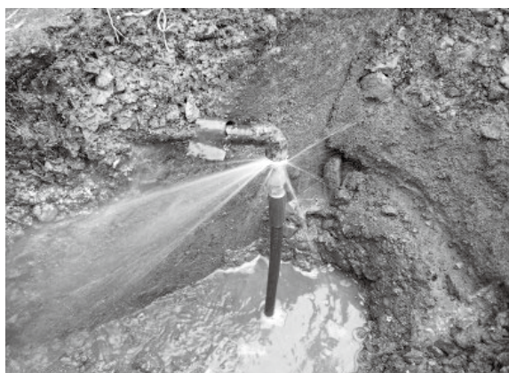
▲老朽化した水道管
