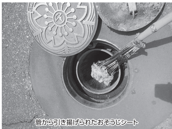
詰まったマンホール 原因は…油、髪の毛・繊維など
